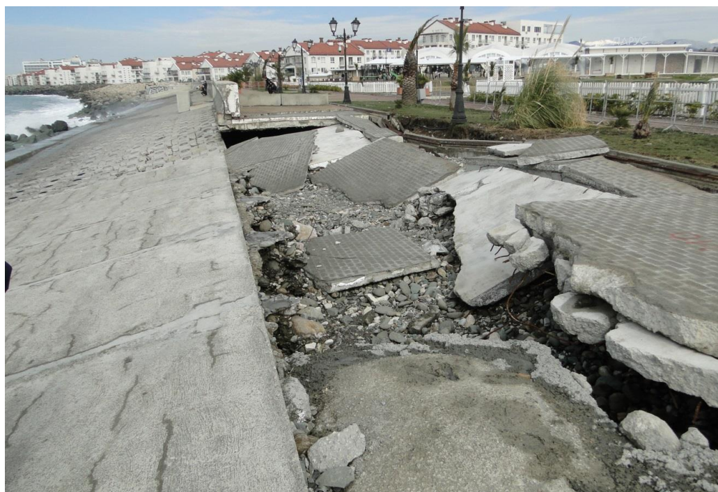
Рисунок 3 – Разрушение откосного бетонного крепления (а) и набережной (б)
